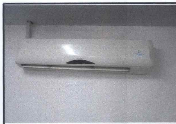
FOTO Nº 6: ITEM167 - COND. DE AR SPLIT KOMECO 24.000BTU - JUIZ DE FORA
