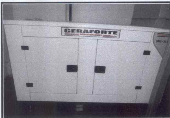
FOTO Nº 1: ITEM 001 - GERADOR A DIESEL 30KVA - JUIZ DE FORA
